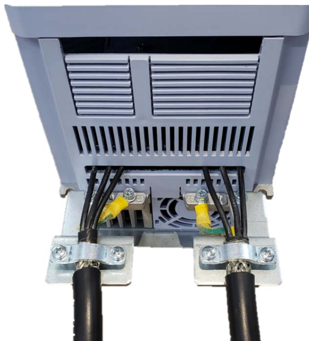
Figura 3.25: Detalhe da conexão da blindagem dos cabos do motor
