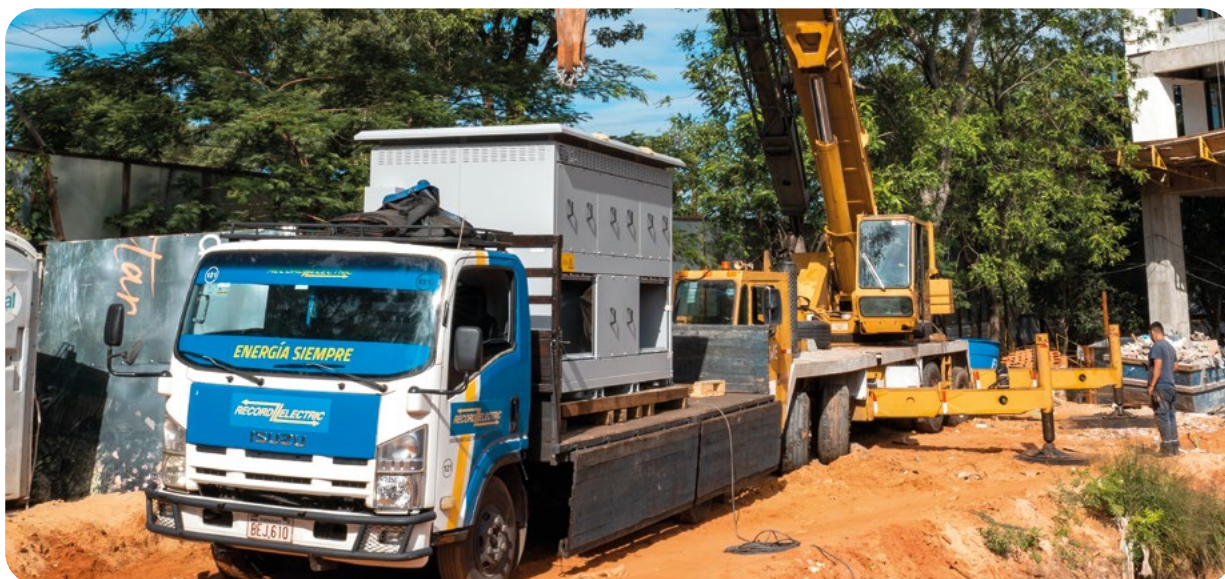
5. Provisión de 8 transformadores secos WEG (6 de 2.000 kva y 2 de 630 kva) para el Distrito Perseverancia.
